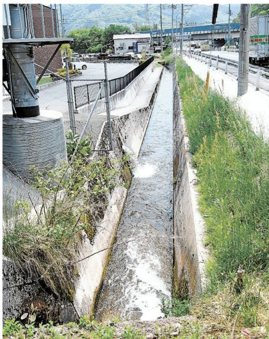
小水力発電設備を設置する新見市の用水路
