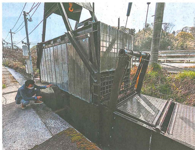
エリスが設置した小水力発電装置。用水の流れと落差で内部の水車を回し、電力を生み出している＝新見市高尾
